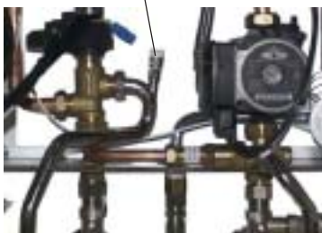
Purga impulsión primario interacumulador
