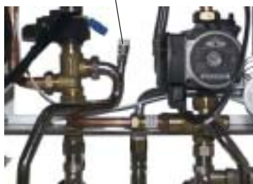
Ontluchting voorloop van de boiler
